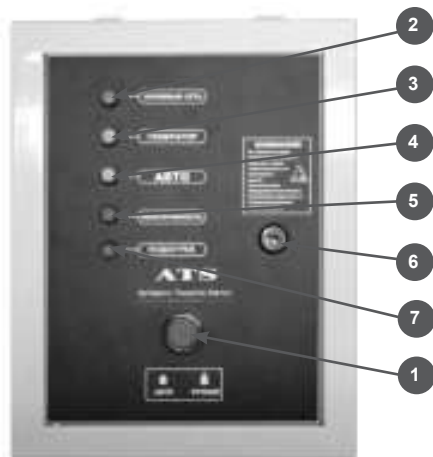
Рис. 14 Контрольная панель блока ATS
