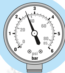
рис. 11. При начале водоразбора, вода, находящаяся в мембране гидроаккумулятора под давлением, начинает подаваться потребителю. При этом давление в системе начинает уменьшаться, а насос остаётся выключенным.
